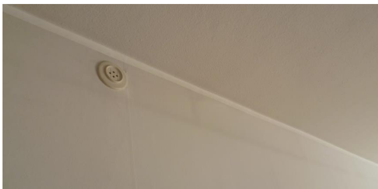
Bild 1. Svärtning på ytterväggen i vardagsrummet.
